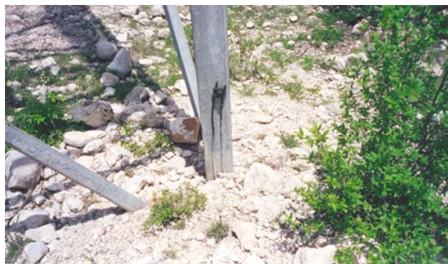
Figura 4.2.2 Quiote bajo la línea de transmisión de alta Tensión, característico de fallas de alta Impedancia.
